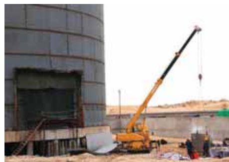
LNG Storage Tank
